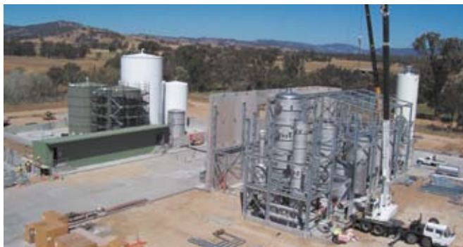
Multi-Feedstock Anlage in Barnawartha, Australien, 2007
