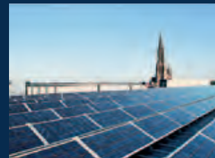
Photovoltaic power plant Deutschhaus Ulm
