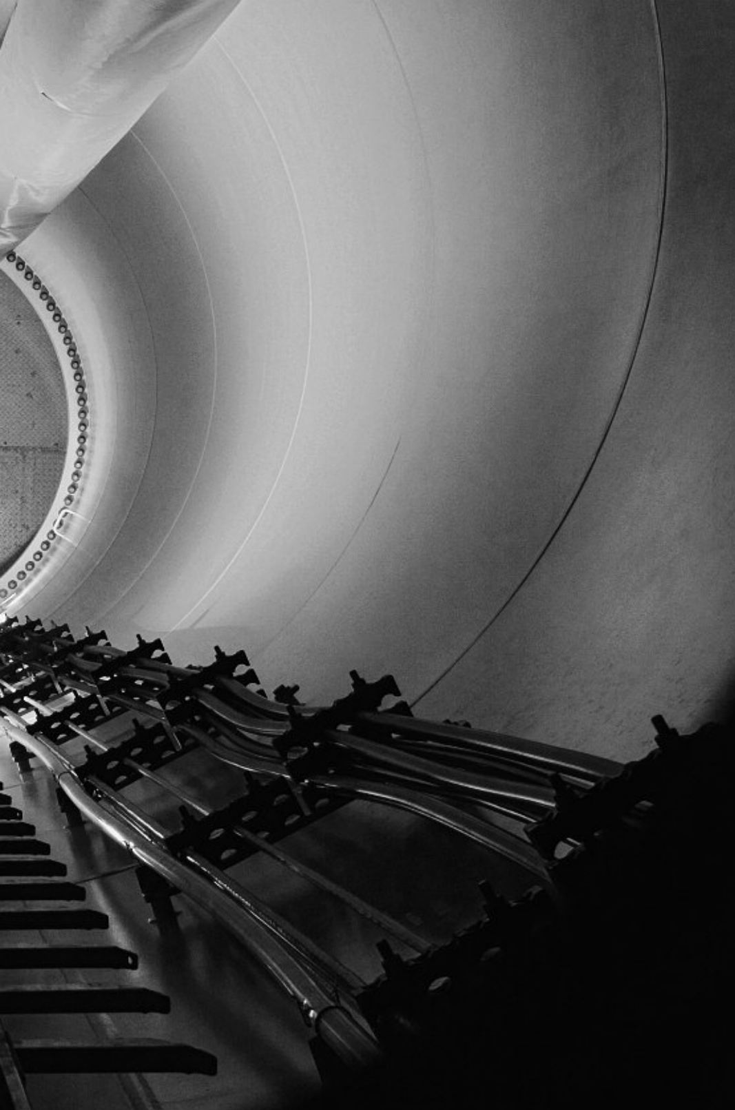
Ein Blick ins Innere – 77 Meter hoher Turm einer Windkraftanlage, Hellenthal-Hahnenberg, Solarparc Windkraftanlage.
