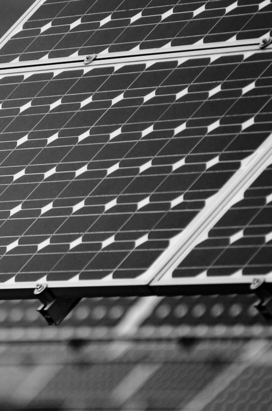
Stabile Leistung – 3.375 Module auf 125 Trackern, Rotvonwerk, Sachsen. In der Solarparc Betriebsführung.
