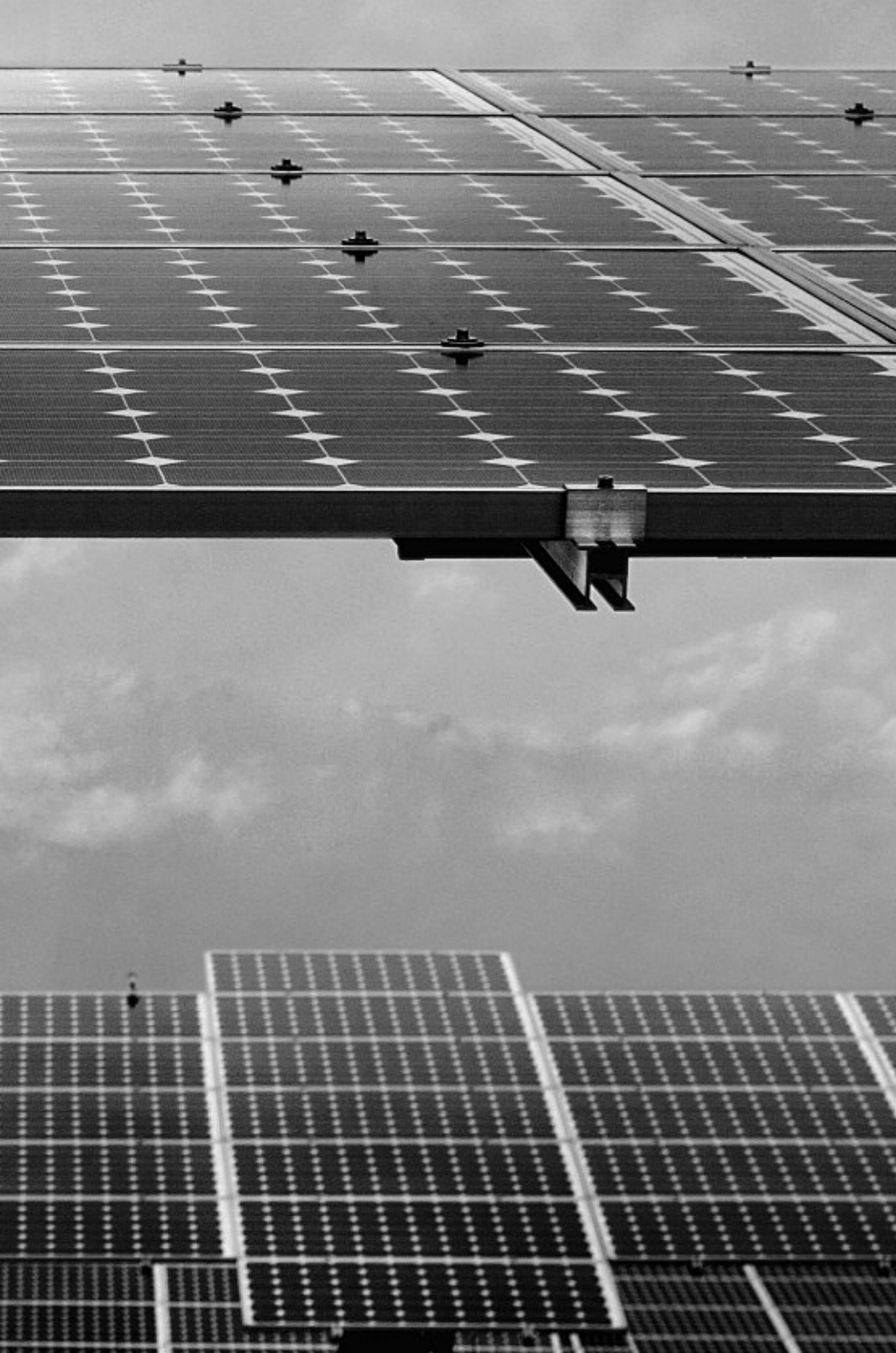
Optimal ausgerichtet – Tracker-Anlage mit Sensor zur optimalen Ausrichtung zum Sonnenstand. In der Solarparc Betriebsführung.
