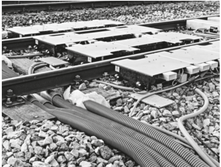
RailWatch-System zur Überprüfung der Radsätze
